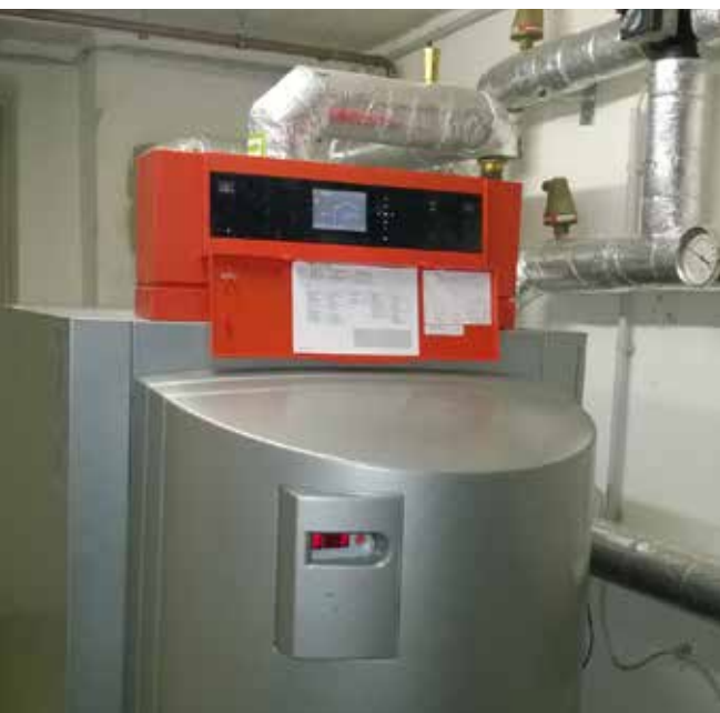
Brennwertanlage Zöllmener Straße
