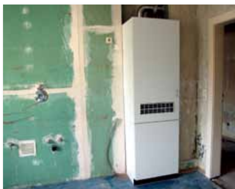
Alte Gastherme in zu sanierender Wohnung
