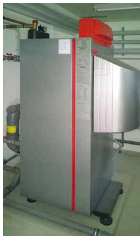
neuer Brennwertkessel im Keller
